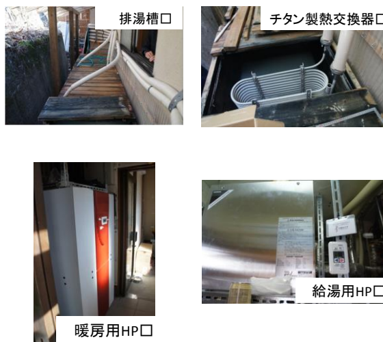
写真 3.1 温泉排湯熱利用システム各設備
